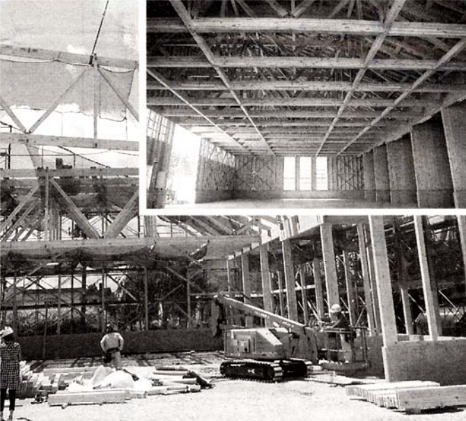
P3+と製作金物を併用することで、コストをコントロールし、スパン13.65mを実現した大島電気倉庫(新潟県)
